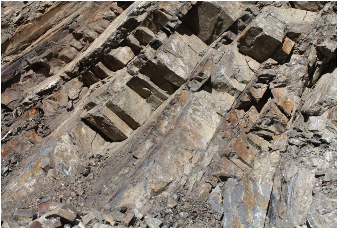
Рисунок Б.21 – Типичные скальные сланцевые обрывы на автодорогах в Высокогорном Дагестане
