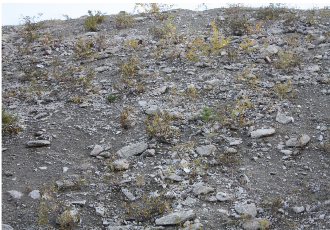
Рисунок Б.23 – Заращение известнякового обломочно-глинистого грунта откоса на северном склоне Гимринского хребта ивой козьей
